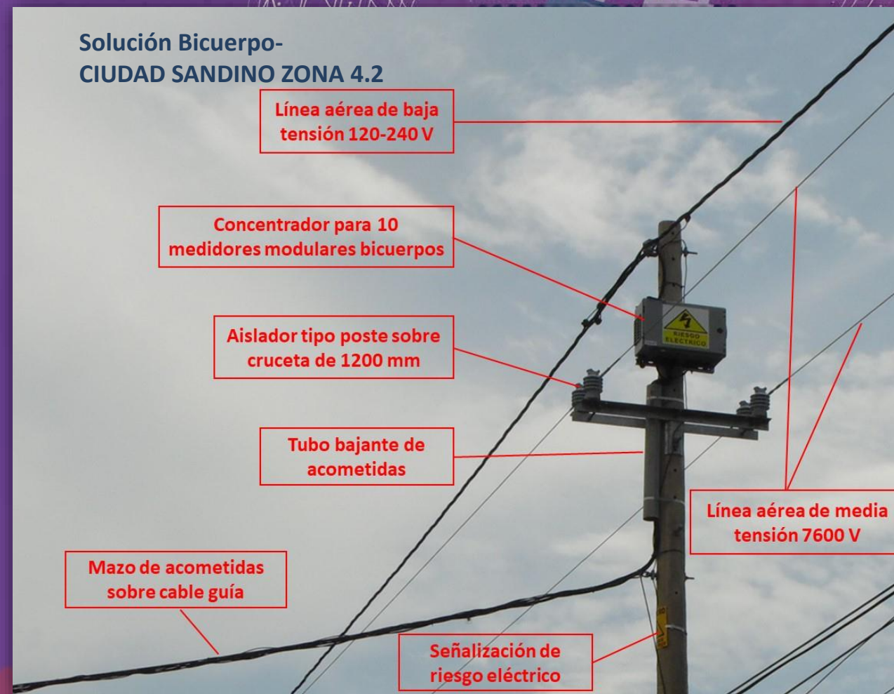
Imagen del PROYECTO CIUDAD SANDINO ZONA 4.2- En se puede apreciar un gabinete Bicuerpo de tercera generación (3G) que posee medidores modulares.
