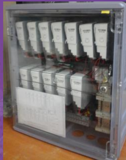
Medidor en Gabinete
